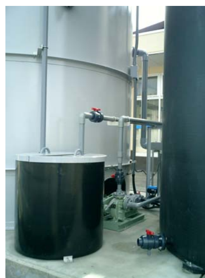
▲ 新設、浮上効M回収槽
