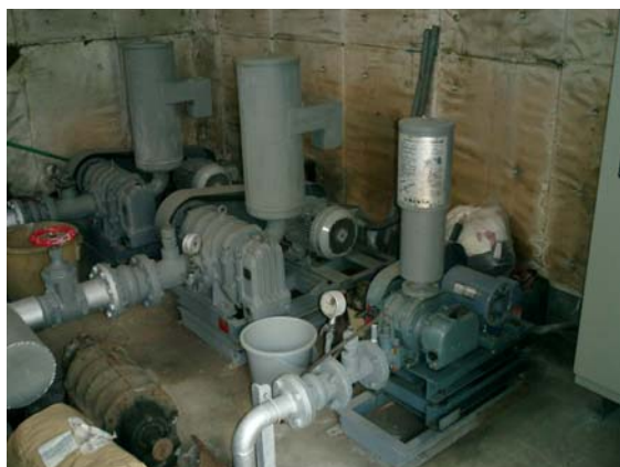
▲ 既設、曝気ブロー-100×2 調整槽ブロー-50
