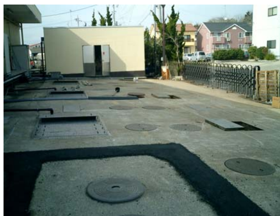
▲ 既設、埋設式排水処理施設 機械室
