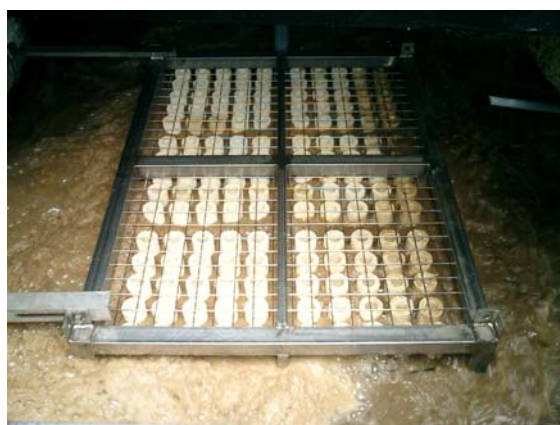
▲ No1接触曝气槽、活性污泥+原水注水
