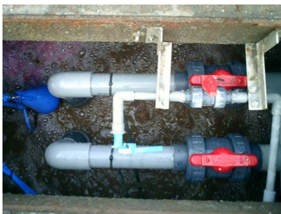
▲ No5曝気槽→No6曝気槽移送ポンプ配管・バルブ
