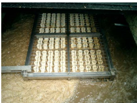
▲ No1接触曝气槽、活性污泥+原水注水
