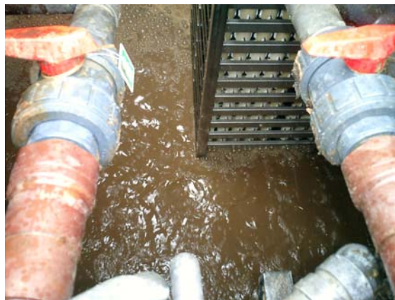
▲ No1接触曝气槽、活性污泥+原水注水
