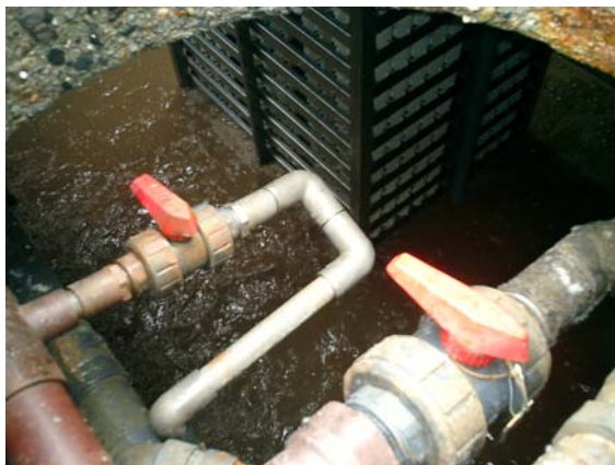
▲ No1接触曝气槽、活性污泥+原水注水
