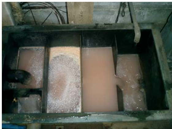
▲ 既設、原水計量槽 (2.5m 3 /h)
