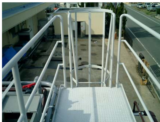
▲ No6曝気槽上点検デッキ
