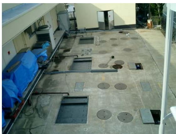
▲ 排水処理施設
