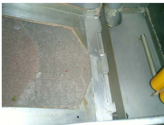
▲ 既設、濾布スクリーン(濾布部分)
